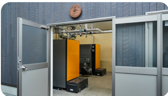
新たに導入したバイオマスボイラー
